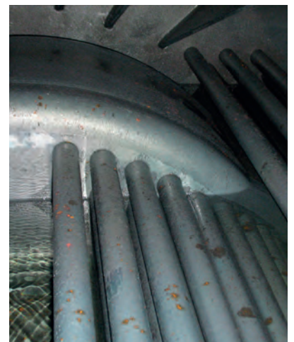
Prima e dopo il trattamento con IDRAVAP
